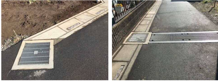
写真 6-1 雨水ますやグレーチング（例）
