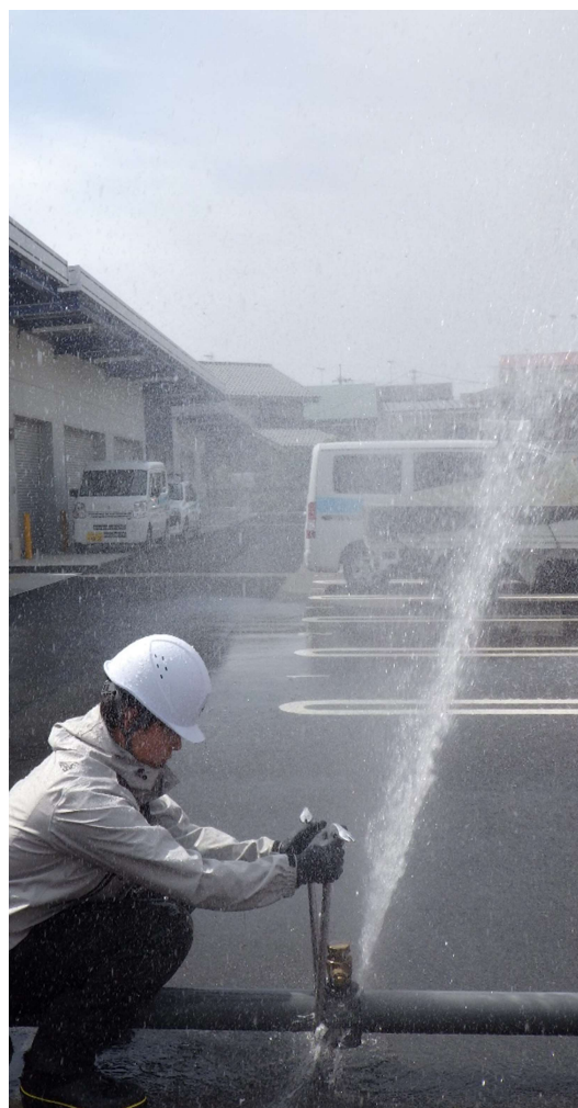
漏水を想定した配水管から水が吹きだしています。
