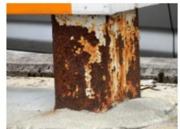
支柱根元の腐食が進行した状態
