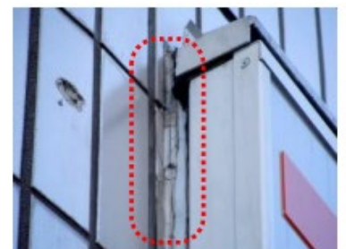
コーキングが劣化した状態
