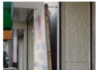
壁面との間に隙間が生じた状態
