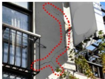
壁面にひびが生じた状態
