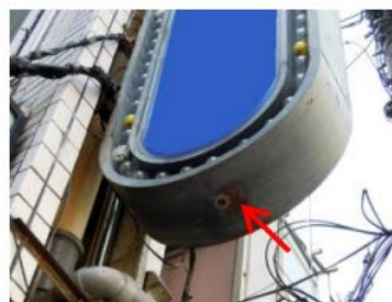
水抜き孔が詰まった状態
