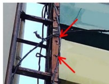
ボルトのゆるみや欠落した状態
