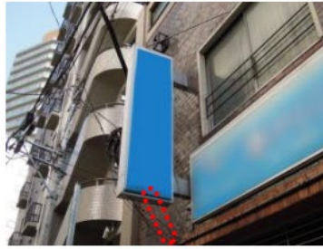
振れ止め棒が変形した状態
