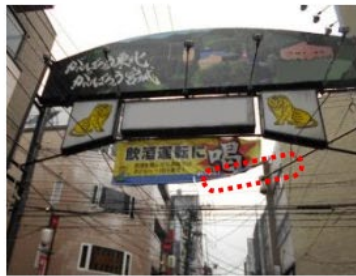
幕材を張る部材が破損した 状態
