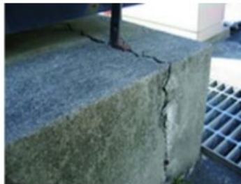
基礎にクラックが入った状態
