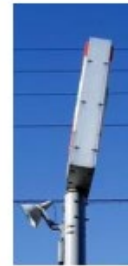
上部構造全体が傾斜した状態
