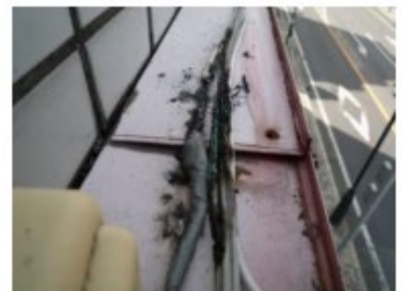
配線が劣化し、ショートした状態
