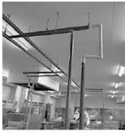
露出配管の市内小学校給食室
