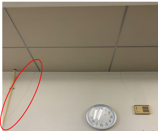
↑ 壁に入った大きな亀裂
